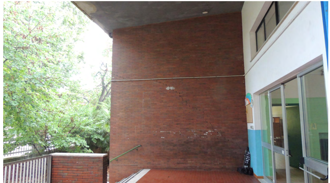
Lesione su parete portante adiacente l'ingresso principale
