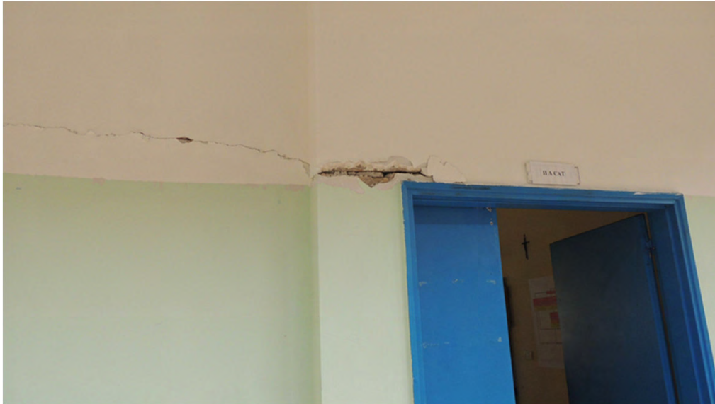
Lesione sull'architrave di una porta di un aula
