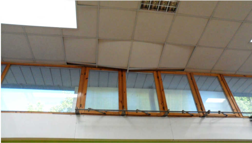
Danno alle controsoffittature
